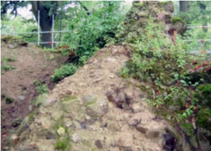
Abb. 25: Eine weitere Mauerkrone, die von Erde und Pflanzen bedeckt ist (August 2006).
