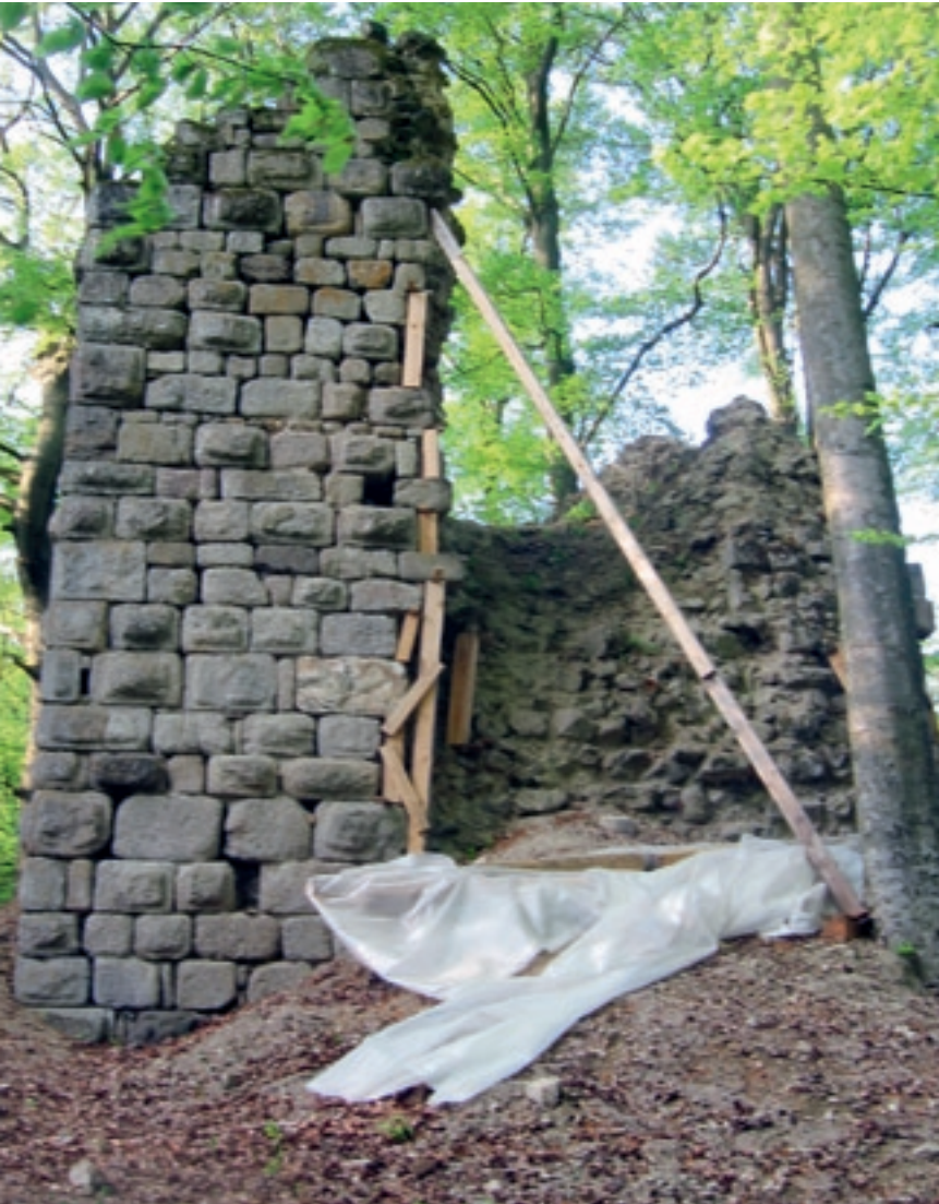
Abb. 21: Fotografie der Westseite mit Stützbalken und heruntergefallener Abdeckplane (Mai 2006).
