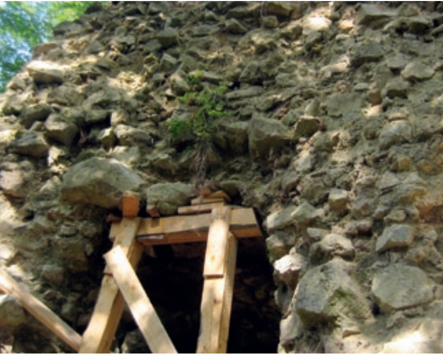
Abb. 13: Die im Lauf der Jahre freigelegte zweite Mauerwerkschicht. Die Steine lagen zum Teil nur noch lose auf und stellten eine Gefahr für Besucher dar (Juli 2006).
