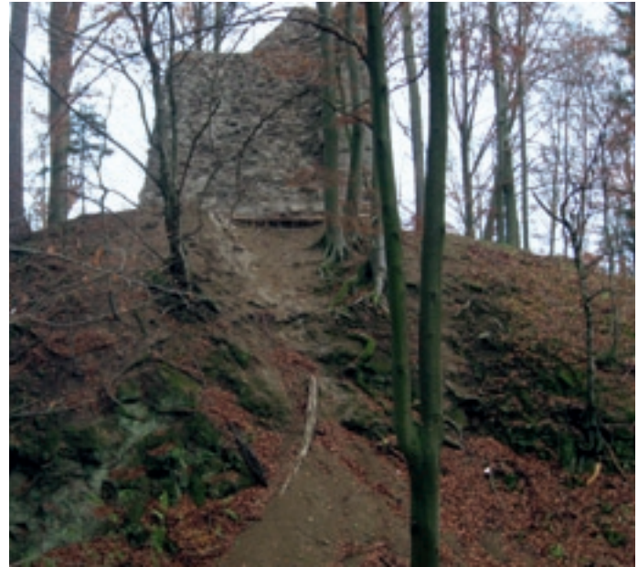
Abb. 34: Die Nordseite. Sehr gut zu erkennen ist, dass der Ausbruch gefüllt und vermauert ist (Oktober 2006).
