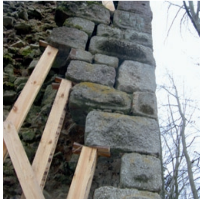
Abb. 14: Balken bewahrten die Nordwestecke des Turms vor dem Zusammenbruch (April 2006).
