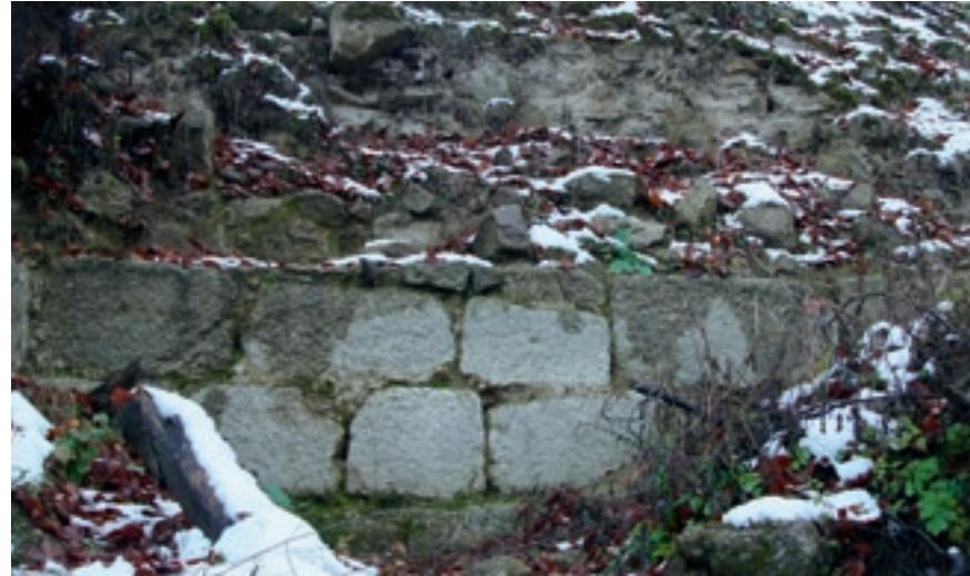
Abb. 10: Ein Teil des Berings, durch einen umgestürzten Baum freigelegt. Die Verfugung der Mauer, die lange Zeit vom Erdreich geschützt und bei der Freilegung intakt war, zeigt nun, erst zwei Jahre später, erste Witterungsschäden (November 2005).
