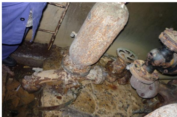
Einer der drei Hydraulischen Widder Fabrikat Sano
