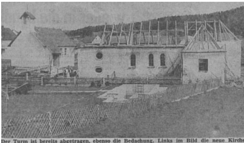
Der Turm ist bereits abgetragen, ebenso die Bedachung. Links im Bild die neue Kirche.
