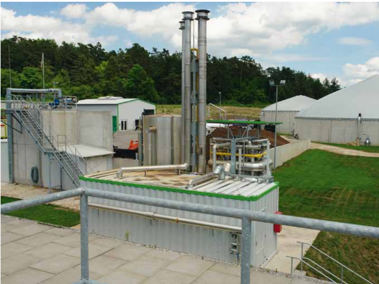
In der Biogasanlage Kallmünz-Eich wird Bioerdgas aus angelieferter Biomasse erzeugt.
