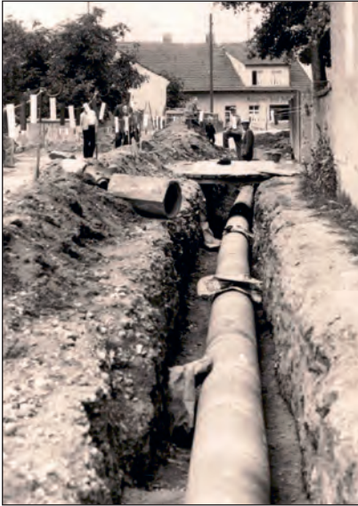
Abb. 18: Entwässerungsanlagen in der Ringstraße. Im Hintergrund die heutige Metzgerei Dengler
