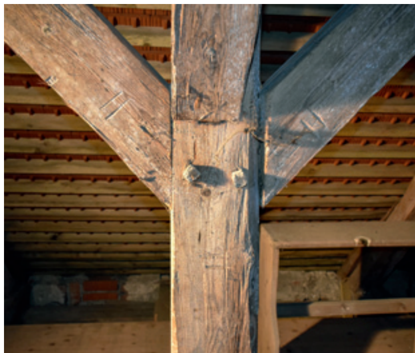
Abb. 15: Abbundzeichen am Dachstuhl über dem Kirchenschiff
